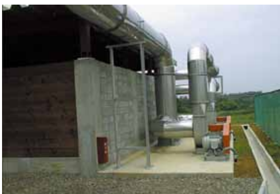
臭気収集ダクトとプロア部
