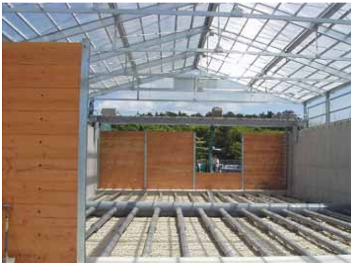
脱臭棟・エアレーション配管
