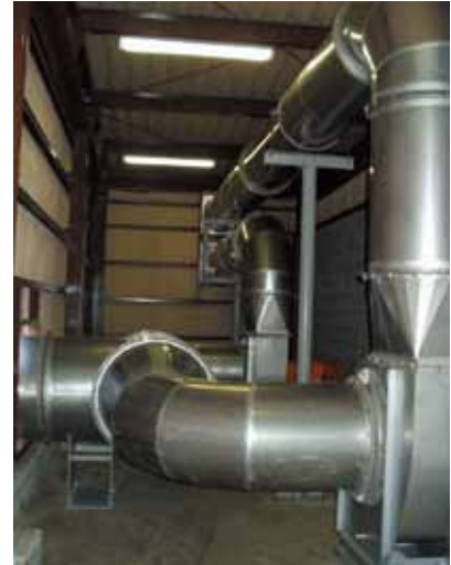
脱臭プロアと収集ダクト
