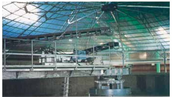
発酵槽内部▶ 臭気捕集ルーフ。原料分配コンベア
