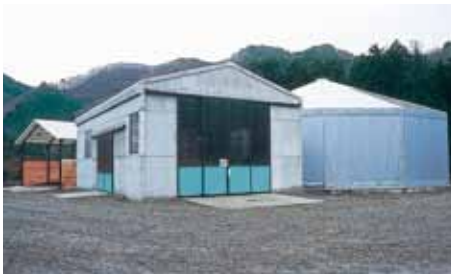
▶全密閉型発酵プラントと原料投入棟
